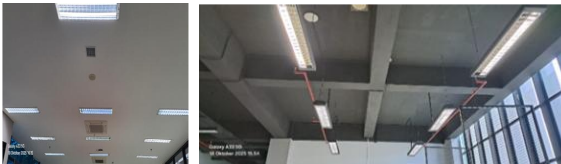
Gambar 4. 2 Implementasi Lampu LED Hemat Energi pada Gedung Politeknik Negeri Batam
